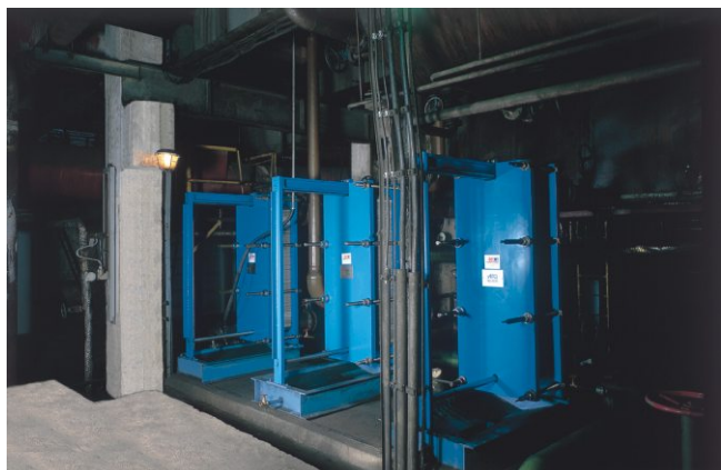
Chlazení oleje turbíny TG-2 a TG-4 o výkonu 50 MW, s olejovými záchytnými vanami, Sokolovská uhelná, a.s., závod Vřesová (ukázka environmentálního řízení výroby)
