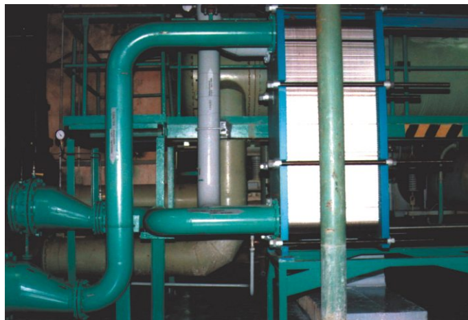
Letní chladič kondenzátu v JE Dukovany
