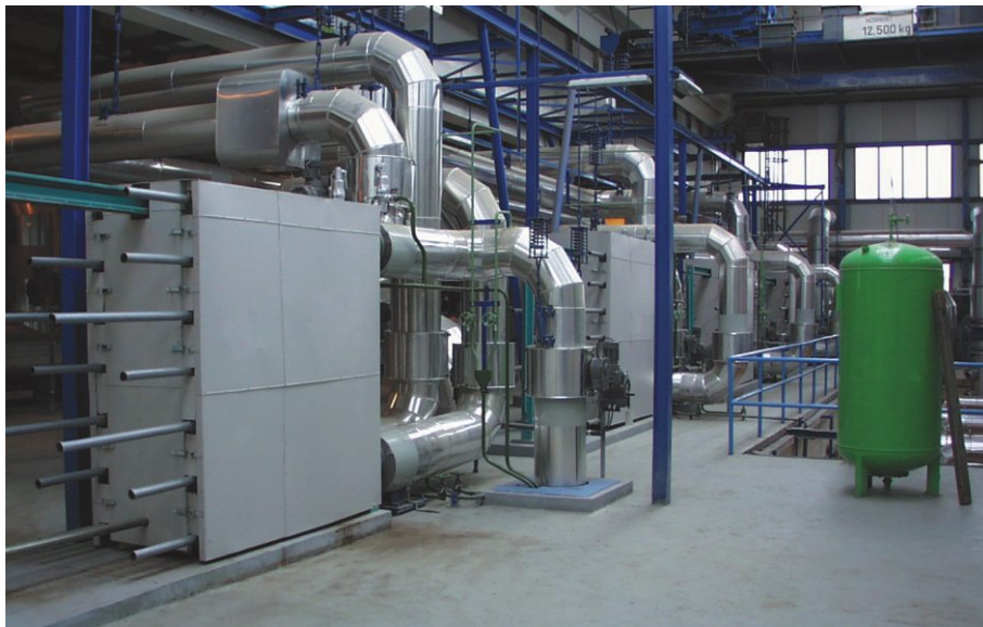
Elektrárna Červený mlýn Brno, výměňiková stanice akumuláčních výměňiků 4 x 14500 kW
