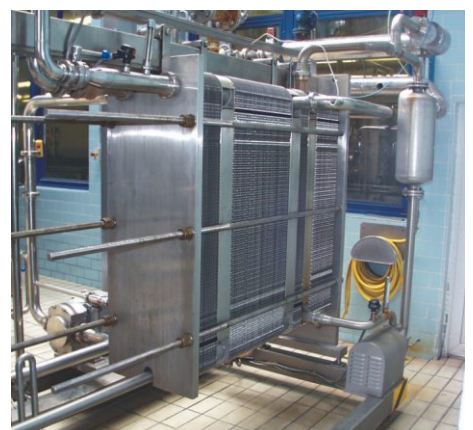
Výměňik pro pasterizaci - Karlovarské minerální vody Mattoni
